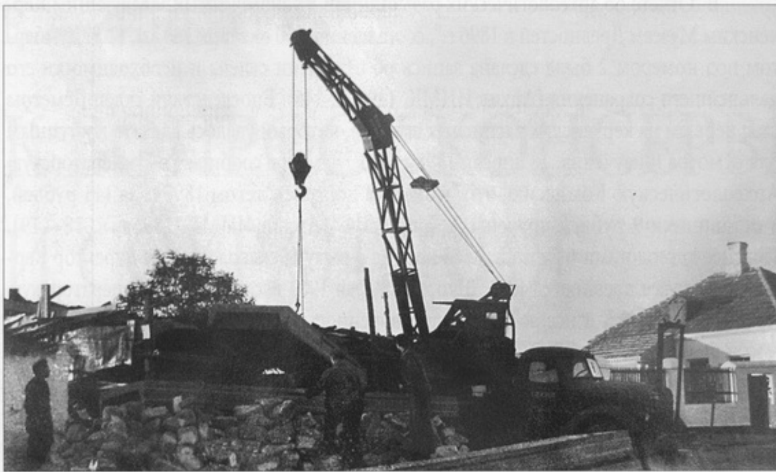
Рис. 1. Работы по укладке железобетонных плит перекрытия над склепом Деметры в 1959 г. (Архив КИКЗ)
