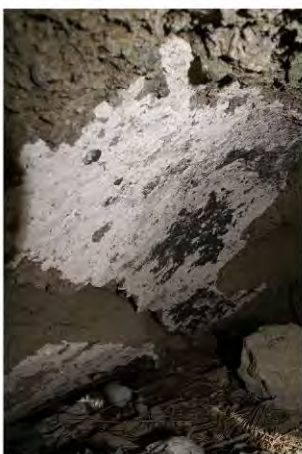
Фото 22. Помещение со следами штукатурки. Остатки штукатурки под рухнувшей каменной глыбой.
